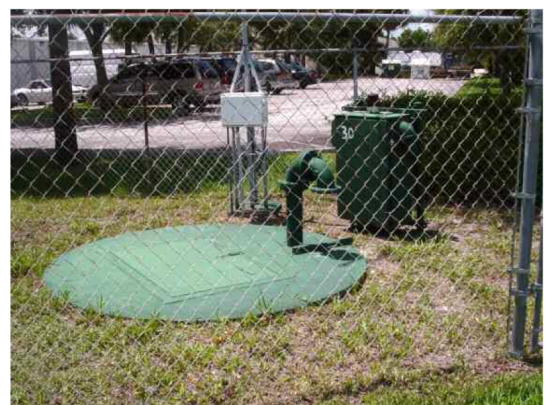
Odores de Estação Elevatória e controle de bactérias transportadas pelo ar
